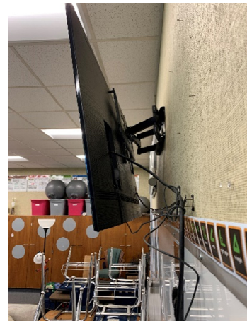
Typical Loose AV Cables
